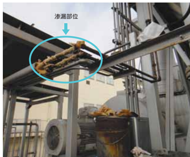
针对管道中柴油渗漏问题而开展的横向措施
